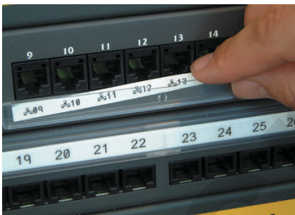
Etiquetas bloques de cableado
